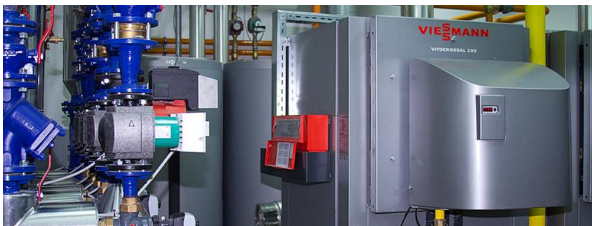
Slika 45: Primer sistema za kogeneracijo toplote in energije na plin. Na sliki so prikazane tudi toplotne črpalke. Slika prevzeta iz vira (Zemeljski Plin, 2015).
