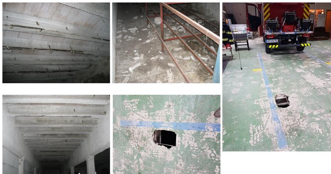
Slika 5: Znaki dotrajanja objekta - razpadanje plošče
