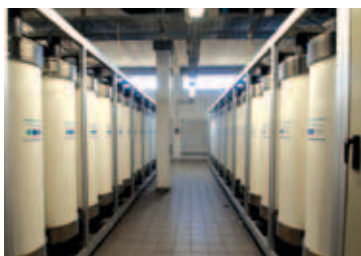
Pogled na nove ultrafiltracijske module
