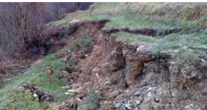
Sanacija zemeljskega plazov v Krnici je bila nujna, potencialno nevarnost na tem območju so predstavljale obilne padavine.
