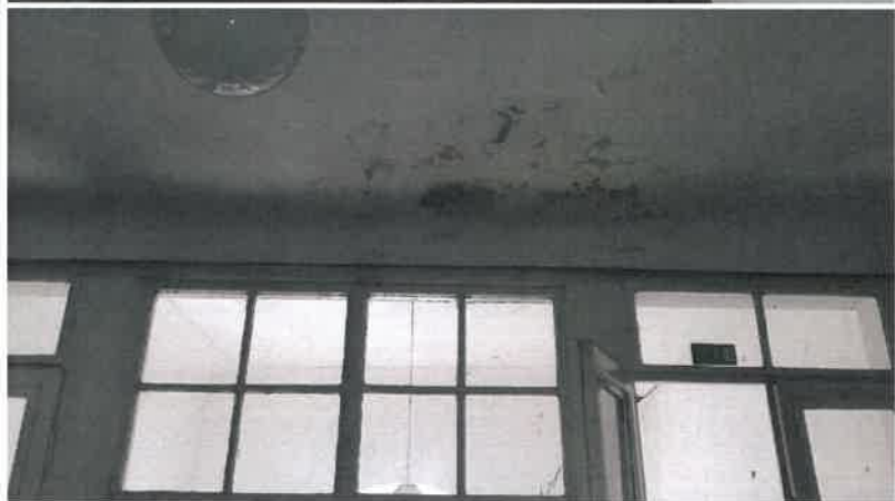
Poškodbe zaradi puščanja strehe
