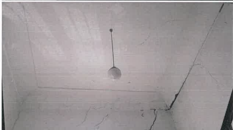
Strop na stopnišču
