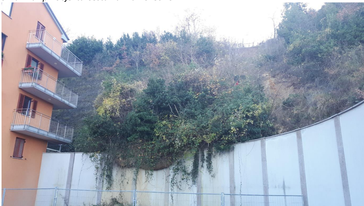
Slika: Plaz pri objektu Cesta na Markovec 19i
