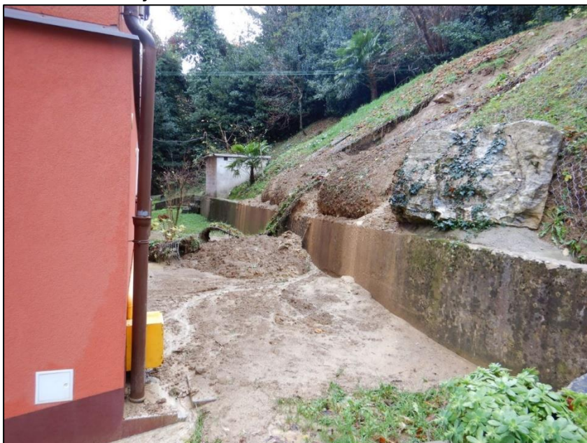
Slika: Plaz za objektom Cesta na Markovec 31
