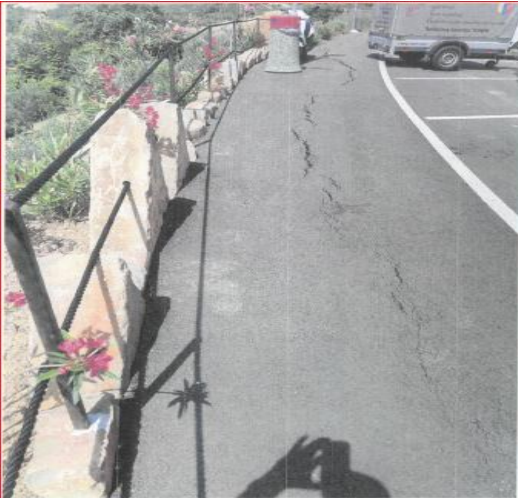
Posedla površina parkirišča
