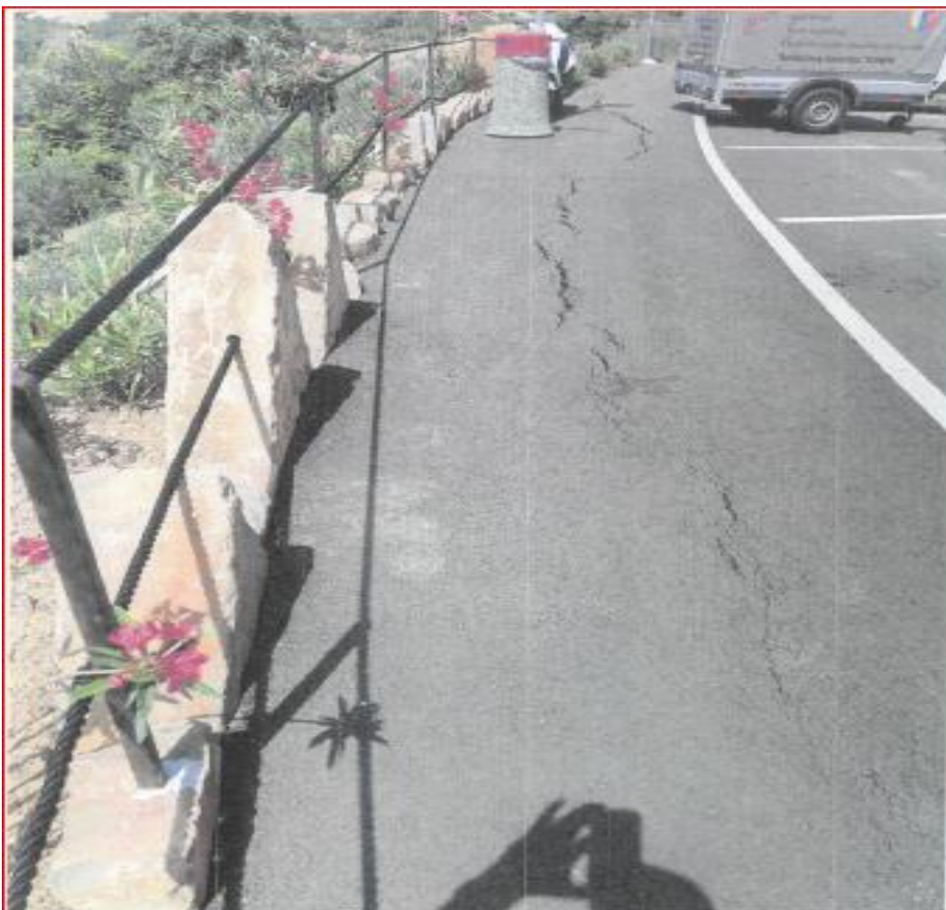
Posedla površina parkirišča
