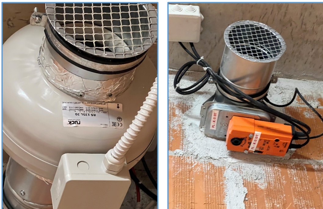
Slika 8: Primer odvodnega ventilatorja in požarne lopute, oboje z mrežico
