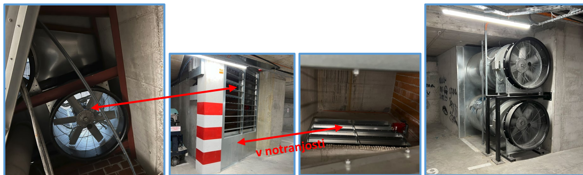
Slika 6: Stanje vgradnje obeh parov odvodnih požarnih ventilatorjev
