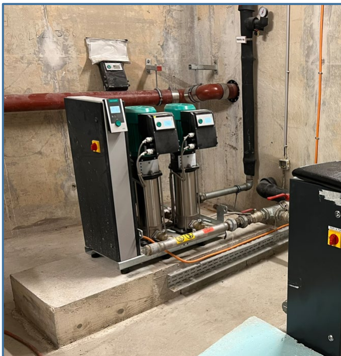
Slika 4: Naprava za dvig tlaka hidrantne vode pri požarnem bazenu
